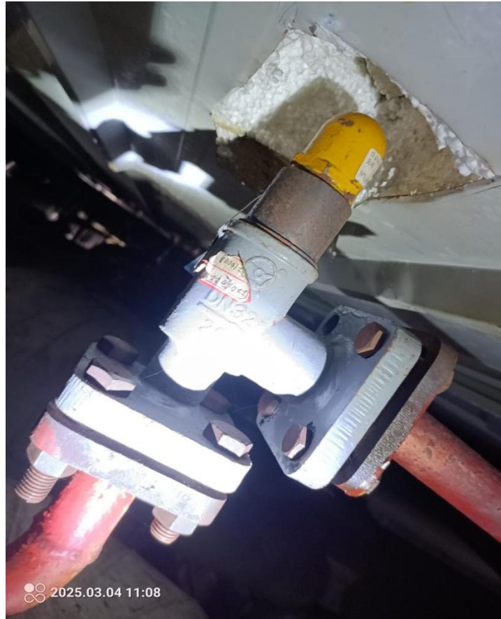
图5 6#低压循环桶安全阀出口法兰缺螺栓、错位
